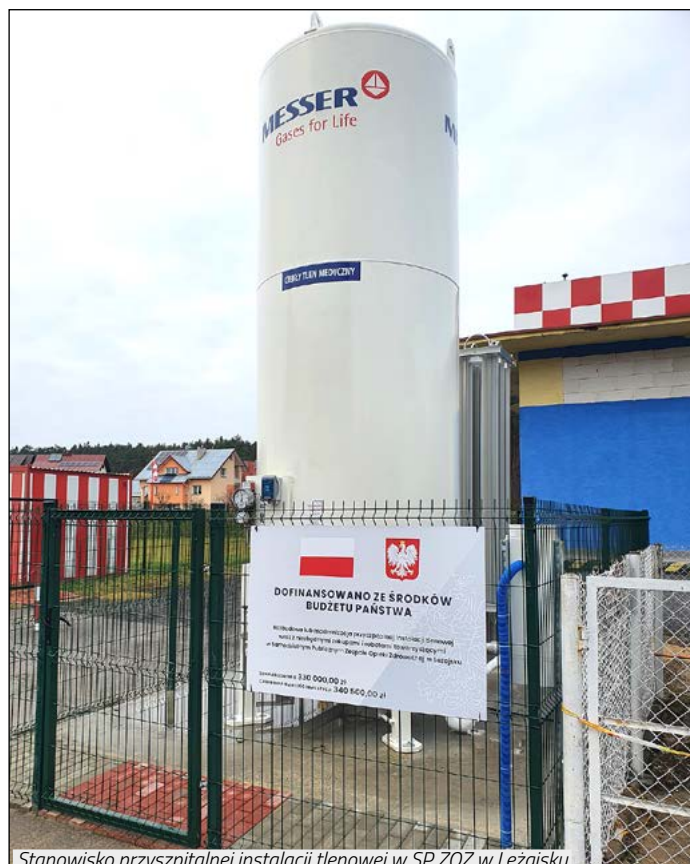
Stanowisko przyszpitalnej instalacji tlenowej w SP ZOZ w Leżajsku
