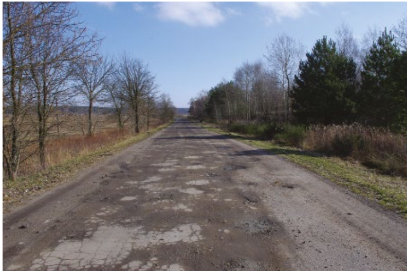
Droga nr 1254R Ożanna – Piskorowice (stan obecny)
