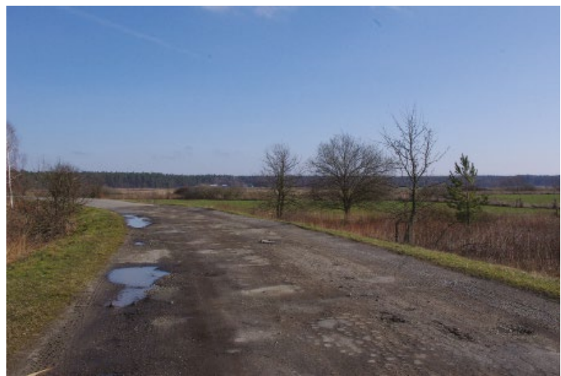
Droga nr 1254R Ożanna – Piskorowice (stan obecny)
