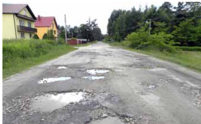
▲ Droga Brzyska Wola – Kolonia Polska przed remontem.
