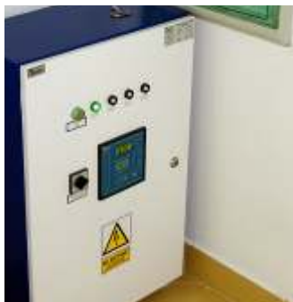
▲ Regulowana bateria kondensatorów.
