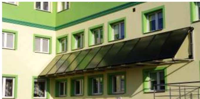
▲ Instalacja solarna na DPS-ie w Brzózce Królewskiej.
