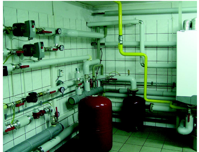
Kotłownia gazowa w Domu Dziecka w Nowej Sarzynie
