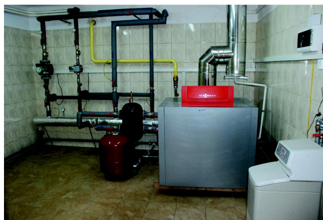
Kotłownia gazowa w JRG w Nowej Sarzynie
