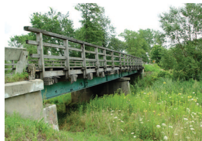
Most w Hucisku przed remontem
