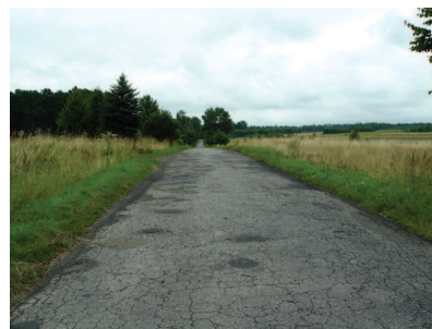
Droga Maleniska-Hucisko-Łętownia przed remontem
