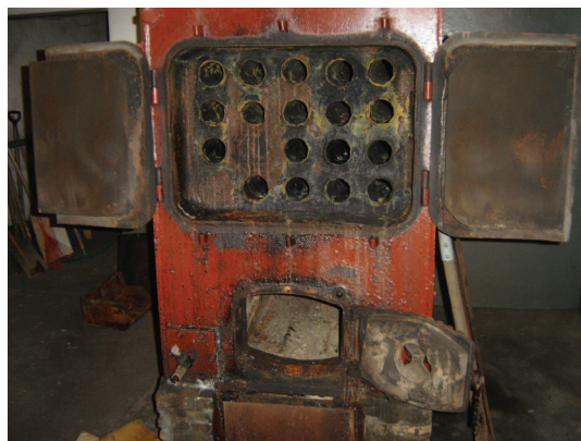
Stara kotłownia: Stary kocioł „obchodził” w 2006 roku dwudzieste urodziny.
