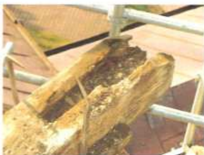
W trakcie prac okazało się, że niektóre elementy konstrukcji wieży są bardzo zużyte.
