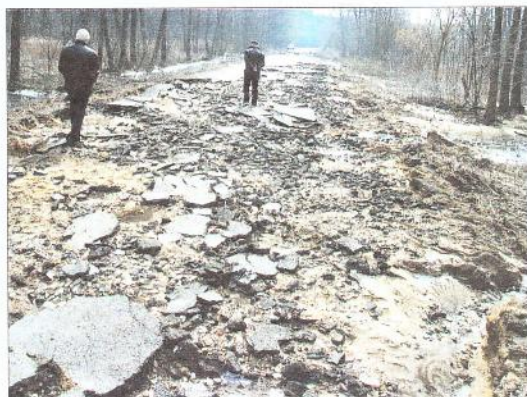
Zniszczona przez powódź droga Brzyska Wola - Dąbrowica (powiat leżajski) - archiwum starostwa.
