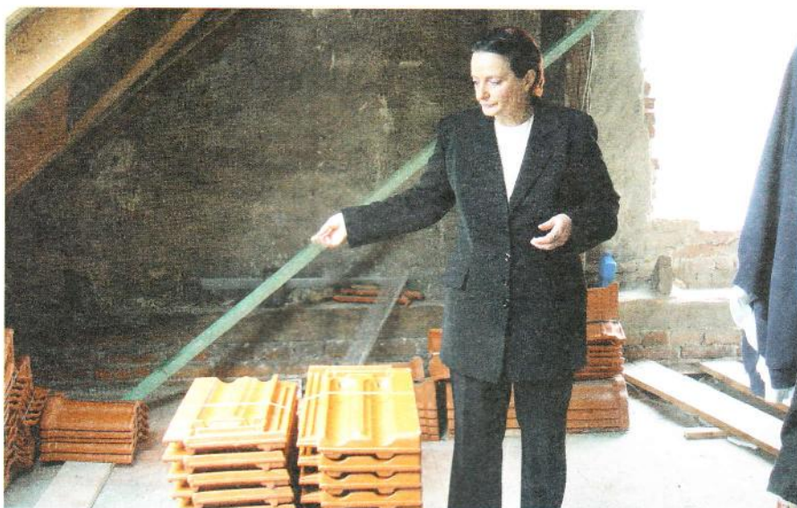
Dyrektor Grażyna Bańka pokazuje fatalny stan poddasza przed remontem
